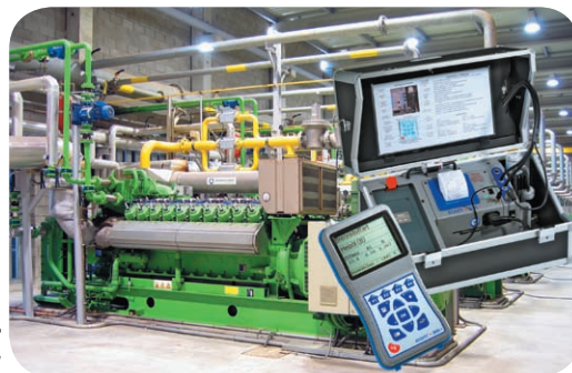
ecom-J2KN an Jenbacher BHKW
